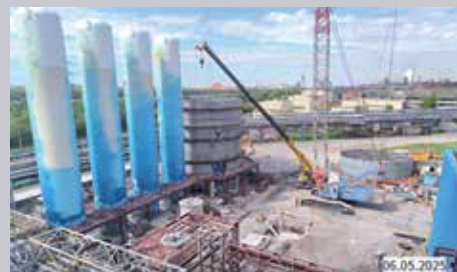
ПАО «ММК». Кислородный цех. Воздухоразделительная установка АКАр-60/60» (Челябинская область, г. Магнитогорск, ул. Кирова, 93) АО «ПРОКАТМОНТАЖ»
